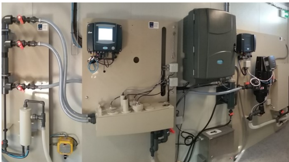
Station de mesure en continu du SIAAP à Clichy
