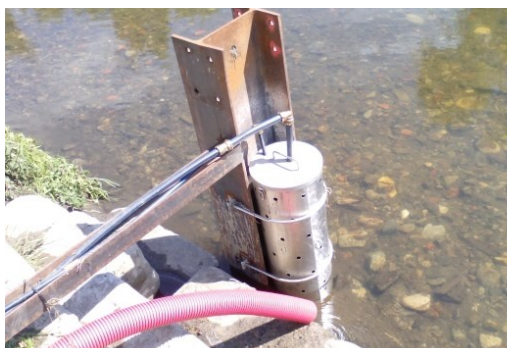
Point essentiel de la station de mesure : La prise d'eau !
